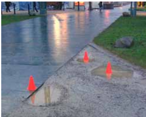
Nicht jede Gefahrenstelle wie hier am Centro lässt sich durch Markierungen erkennen. Fotos: Burkhard Schmidt
