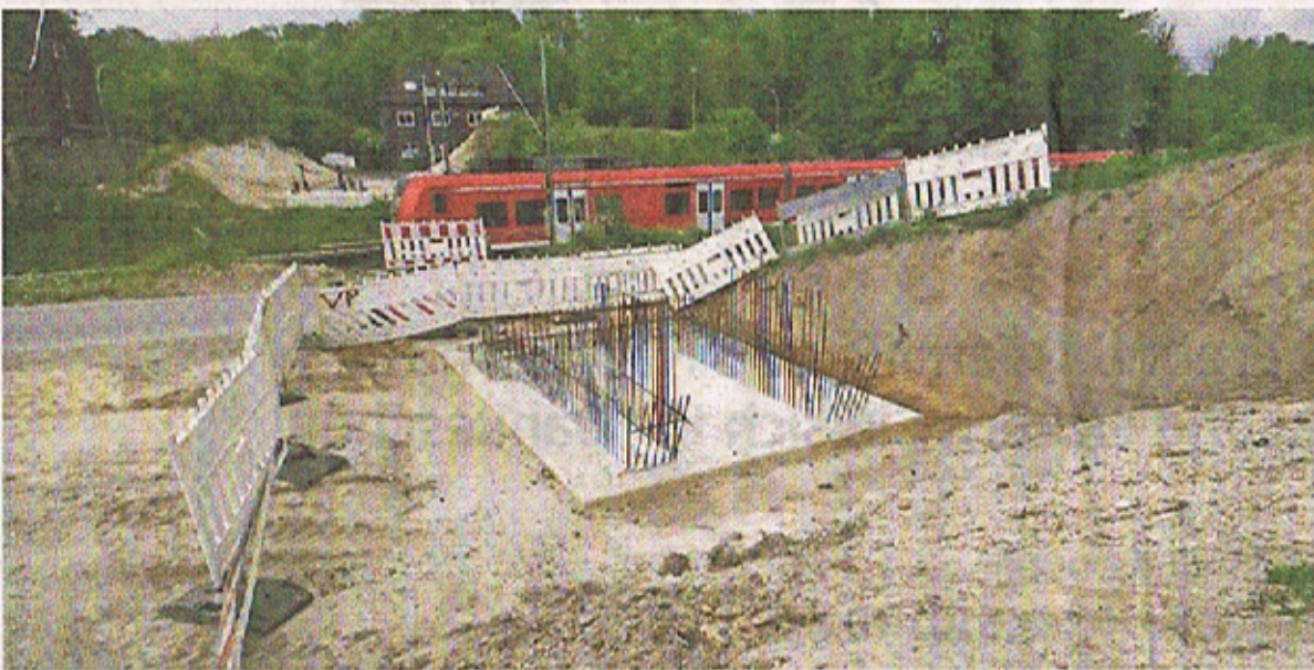
Schon Mitte August könnte die neue, öffentlich geförderte Radfahrer- und Fußgängerbrücke hinüber ins Übach-Palenberger Naherholungsgebiet Wurmatal eröffnet werden. FOTO: DEFI
