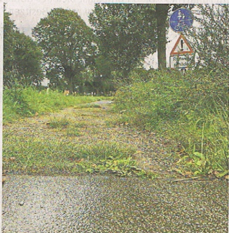
So sieht der Radweg am Wegberger Grenzlandring in der Nähe des Ortsteils Berg aus. Dieser Teilbereich soll im Jahr 2021 erneuert werden. RP-FOTO: HEC
