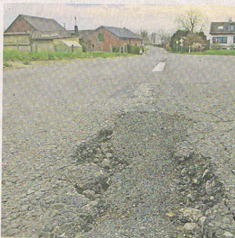
Wie ein Flickenteppich präsentiert sich die Fahrbahn der Landstraße 367 zwischen der Fahrbahndecke soll noch in diesem Jahr begonnen werden.
